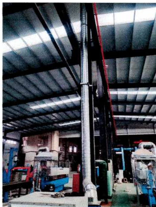
西车间（4#车间）15米排气筒
