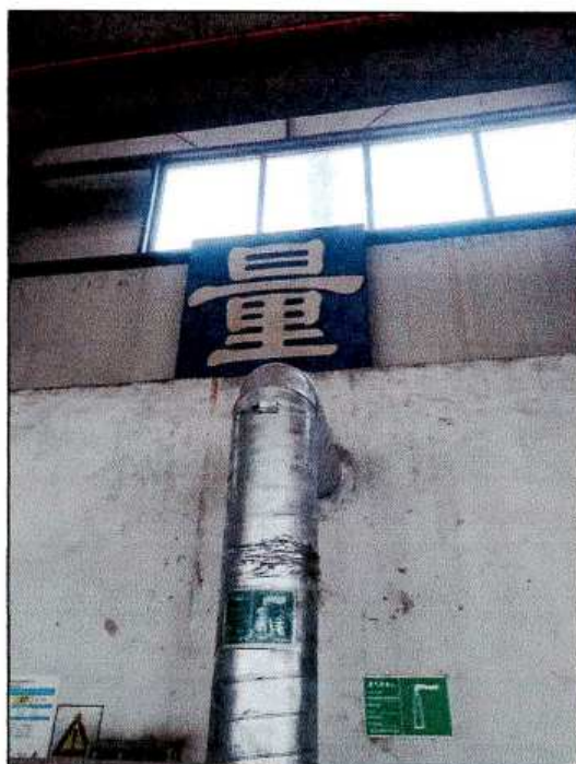
主车间（1#车间）15米排气筒
